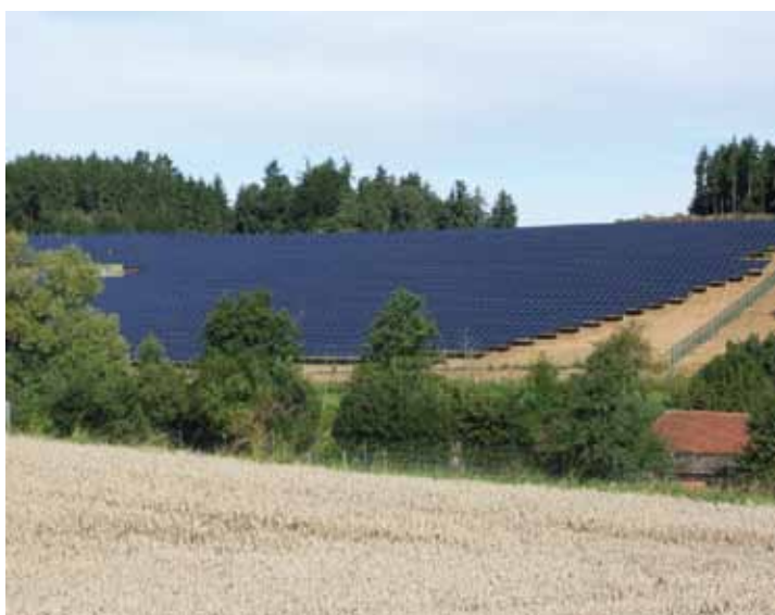
Centrale photovoltaïque, Neufahrn (Allemagne)
